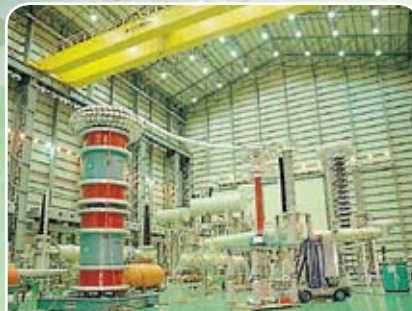
Высоковольтная испытательная установка
