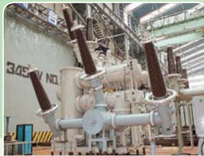
Заводские испытания КРУЭ 145кВ 40кА
